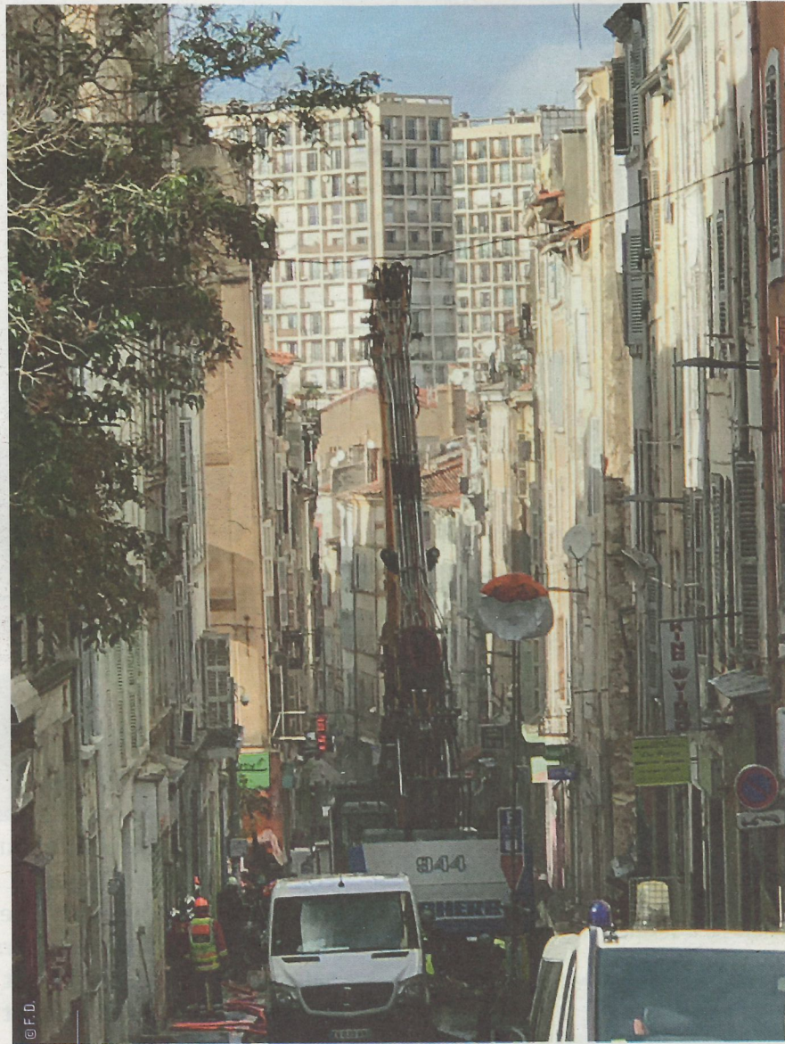
À la suite du drame de la rue d'Aubagne, l'Etat a mis en place un arsenal spécifique.
